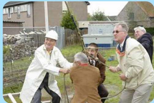
* Wethouder Admiraal slaat enthousiast de eerste paal bij 'het Schelphoekje' (foto: www.goedereede.nl)
